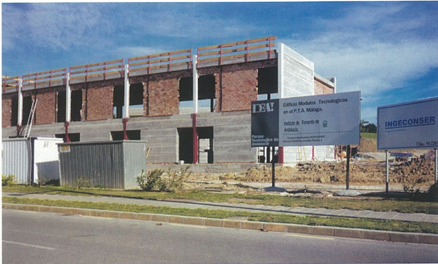
Vista de las obras del nuevo “Edificio de Módulos Tecnológicos” situado frente al edificio Indycce.
